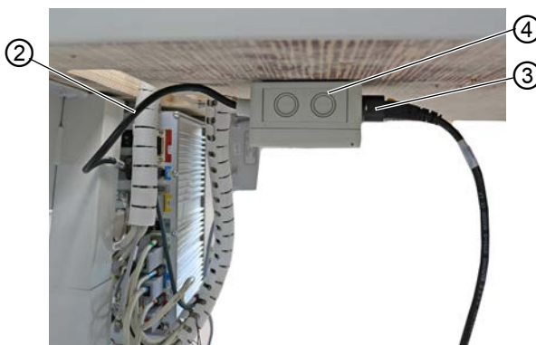
(2) - Câble (3) - Câble électrique
